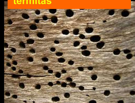
Madera atacada por termitas
