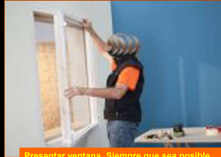
Presentar ventana. Siempre que sea posible el proceso se realizará desde el interior
