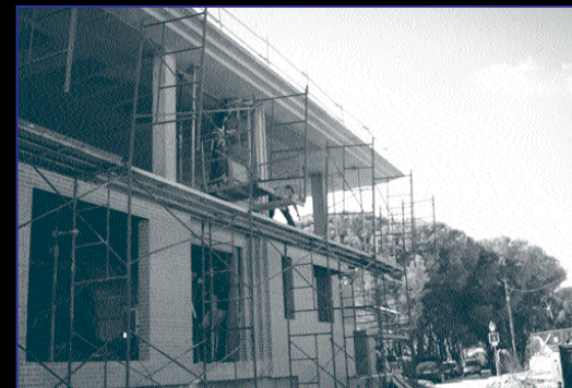
Riesgo caída de altura
